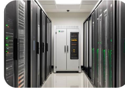
Optimisation et sécurisation de l'alimentation électrique des datacenters
